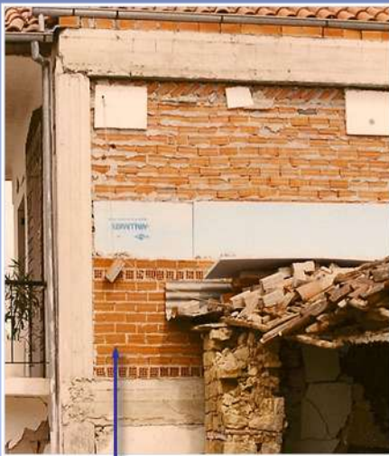
Πτώση εξωτερικού κελύφους σε σεισμό
